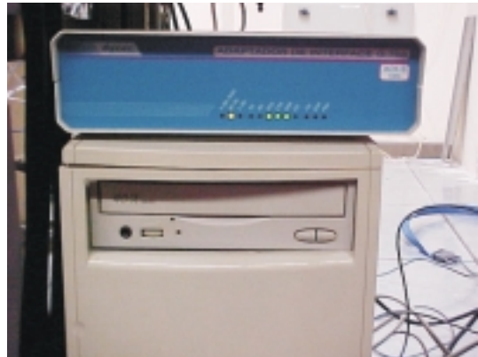
Figura 3. Convertidor DYCEC G703 ADI-S, ubicado en Radio Nou
